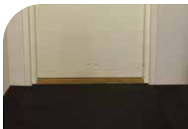
Gulv i teknikrum
