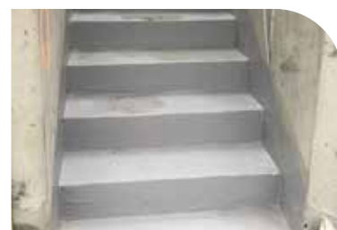
Nylavet trappe før behandling med ELACOAT TopCoat
