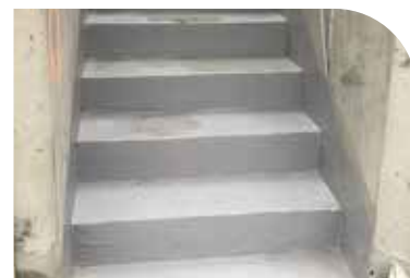
Nylavet trappe før behandling med ELACOAT TopCoat
